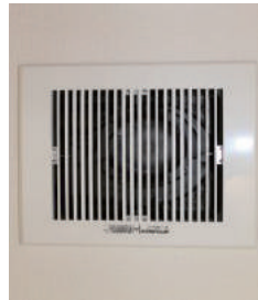
24h換気システム
