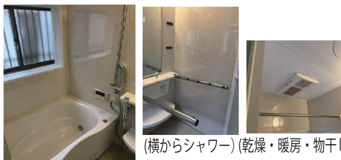
浴室(給湯・追い炊き・自動湯はり)
